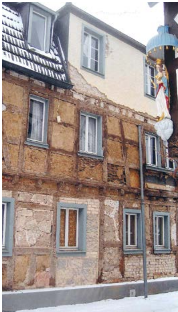
Der abgeschlagene Putz enthüllt einen Teil der Schäden | Bild: Archiv Rudolf Vollmer
